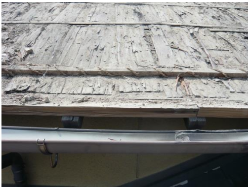
瓦・土をめくり、下地の様子。杉皮・竹・縄が見られる。竹を留めた鉄クギも著しい劣化はない。
